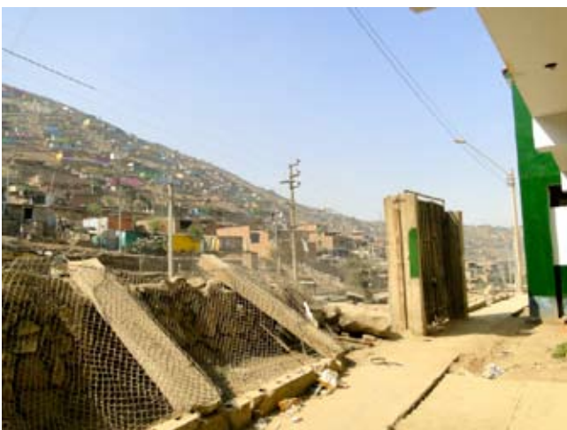
Der Schuleingang ist eingestürzt
